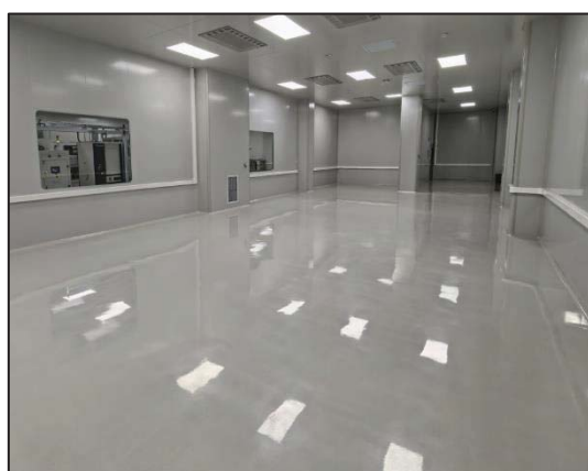
万级洁净间（新增空调）
