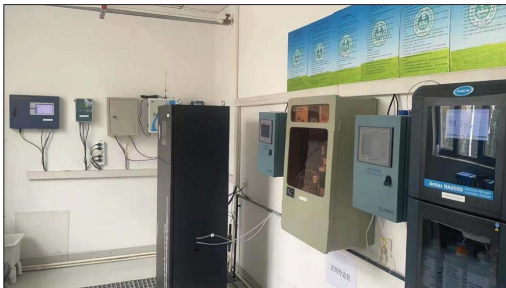
图 2-7 DQ 厂区污水处理中心在线监测设备
