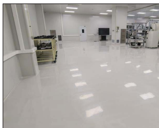
十万级洁净间（利旧改造现有空调）
